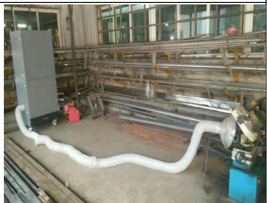
下料处滤筒除尘器
