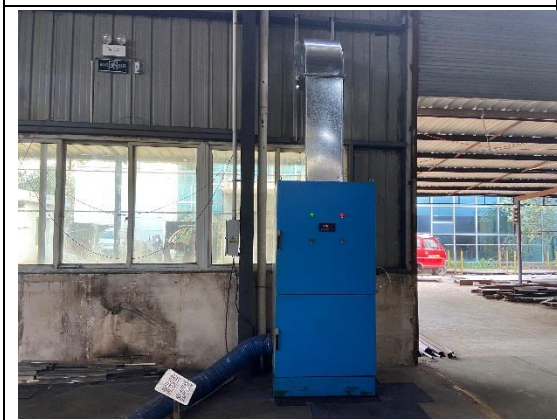
切割烟尘滤筒除尘器
