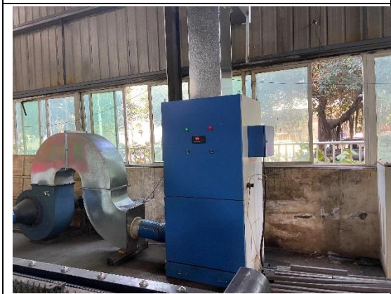
切割烟尘滤筒除尘器
