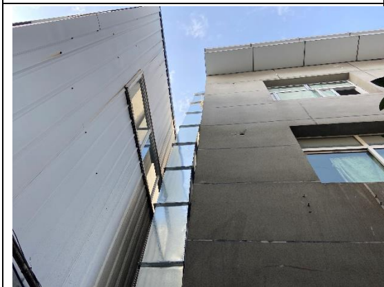
油烟净化器排气筒
